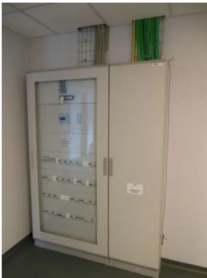
Fase finale: Quadro elettrico Generale
