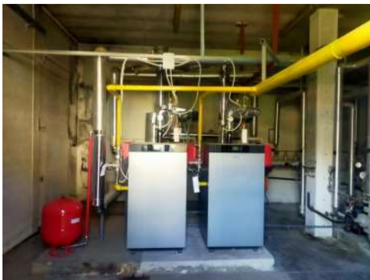
Stato finale dei lavori - CT Liceo Aprosio Ventimiglia. Potenza termica installata 340Kw
