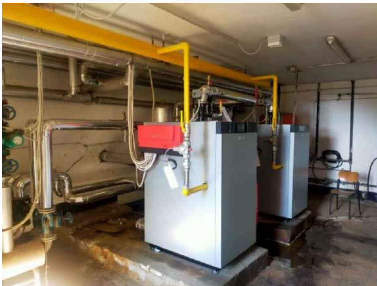
CT Liceo Cassini Sanremo Potenza termica installata 520Kw
