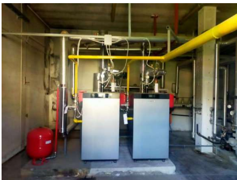
CT Liceo Aprosio Ventimiglia Potenza termica installata 340Kw
