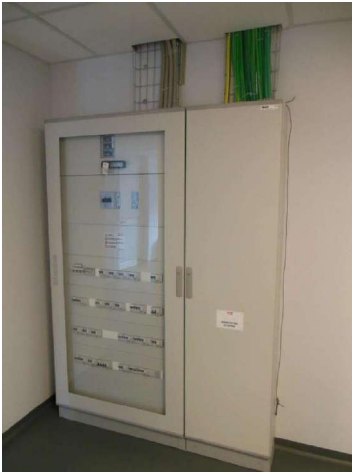
Fase finale: Quadro elettrico Generale di controllo
